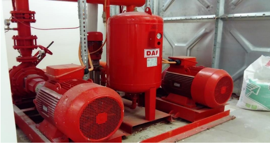
Şekil 6.6 : Tesise ait hidrafor motorları.
