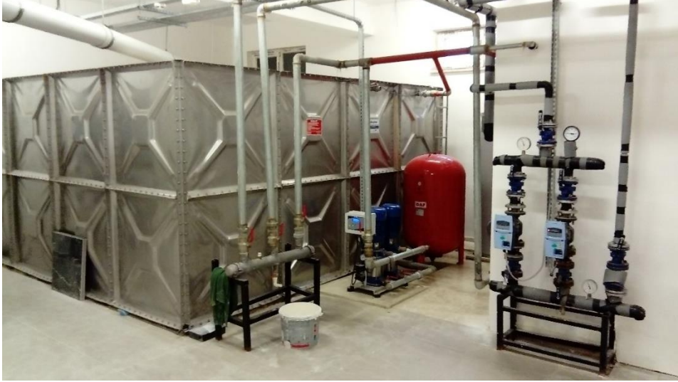
Şekil 6.5 : Tesise ait sirkülasyon pompaları, temiz su pompaları ve kazanlar.
