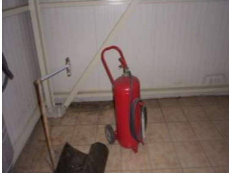
Şekil 3.4 (2019) : Yangın tüpünün yerinin değiştirilmesi.
